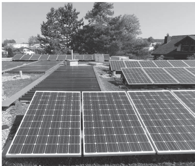
Beispiel einer Gemeinschaftsanlage auf einem Gewerbegebäude. (Foto Leuenberger/ProWeinland)
